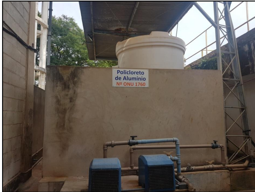
Figura 14 - Tanque de armazenamento de PAC
