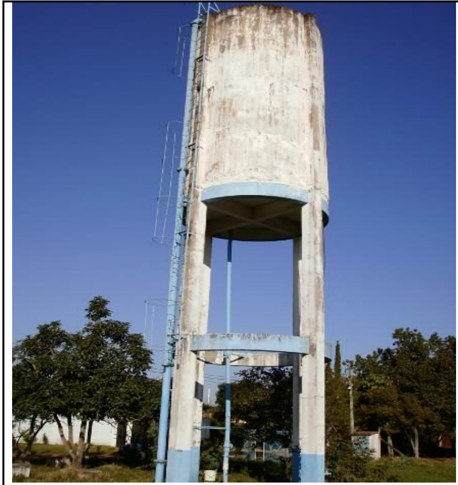
Figura 27 - Reservatório elevado de 50 m 3 do Recanto Solar.
