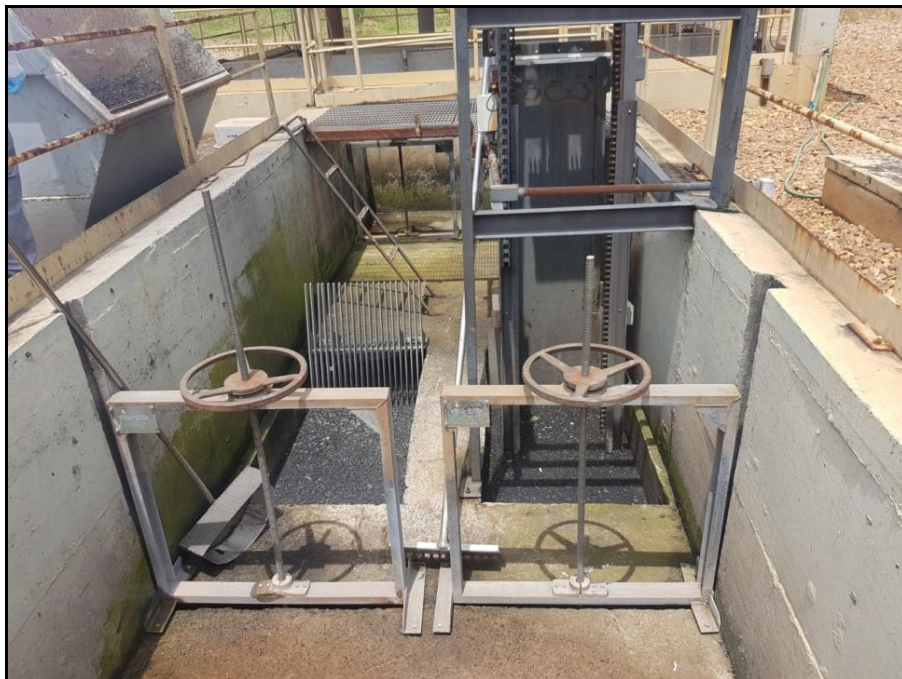
Figura 33 - Caixa de chegada dos esgotos
