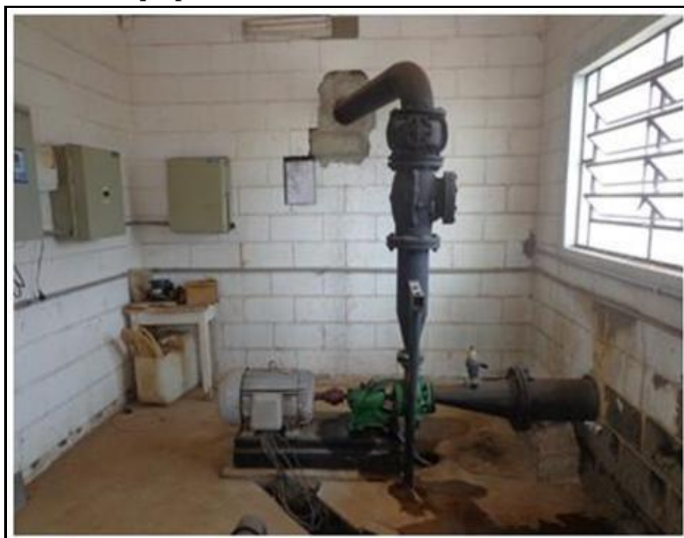
Figura 29 - Recalque para o reservatório Jardim São Francisco
