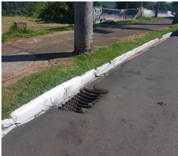
Figura 56 - Boca de Lobo com grelha
