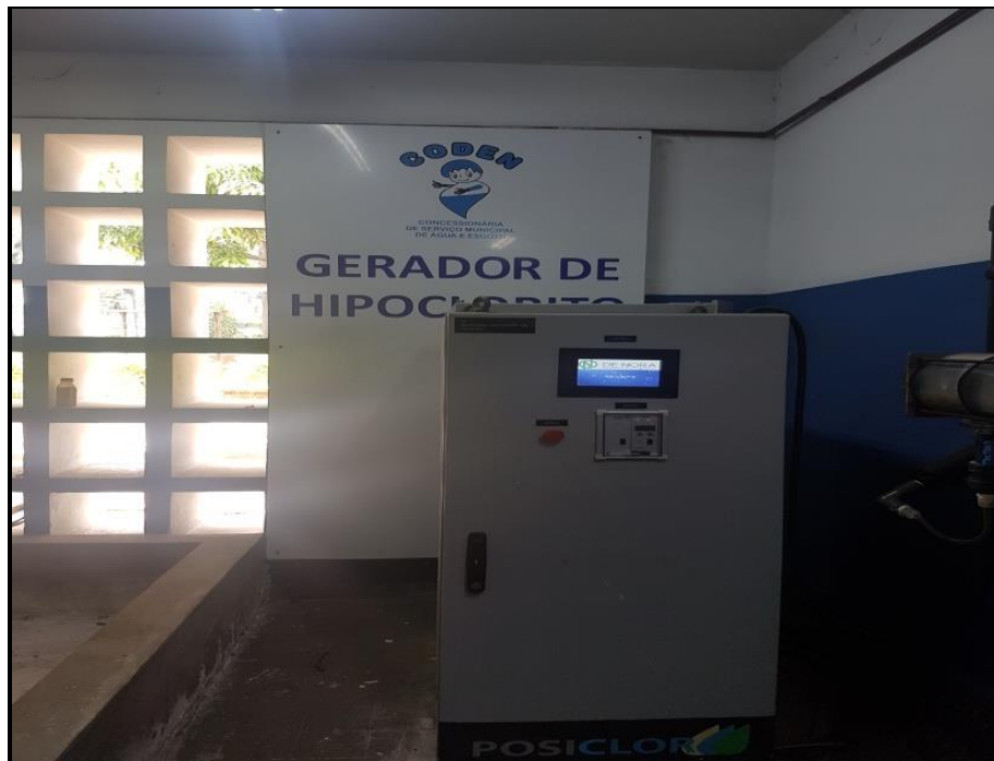
Figura 16 - Gerador de hipoclorito
