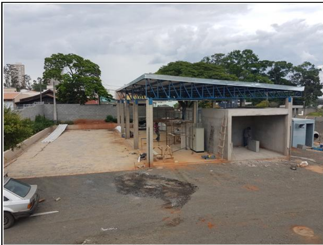
Figura 22 - Instalações para desidratação de lodos
