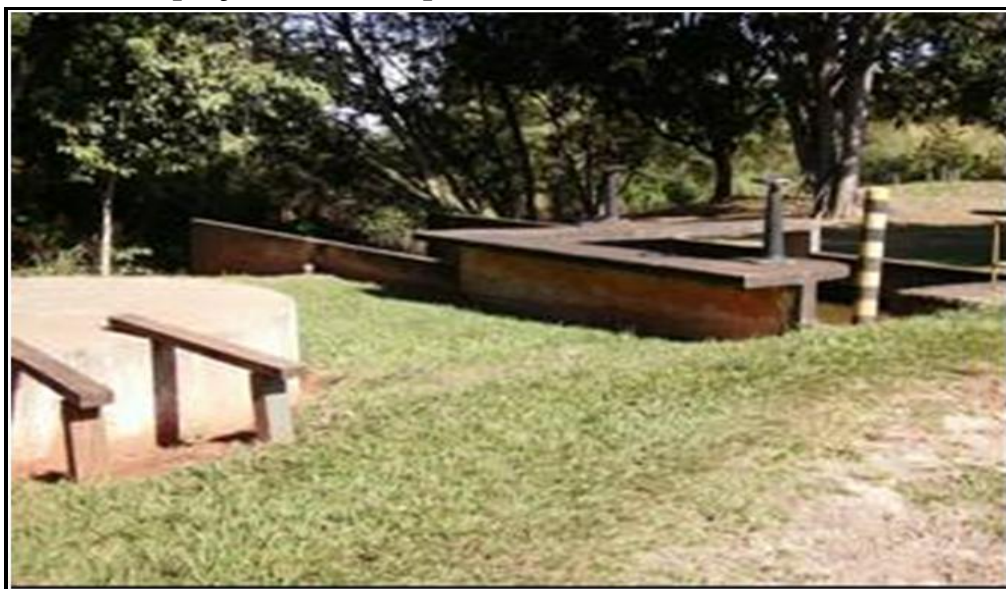
Figura 5 - Captação Sistema Lopes
